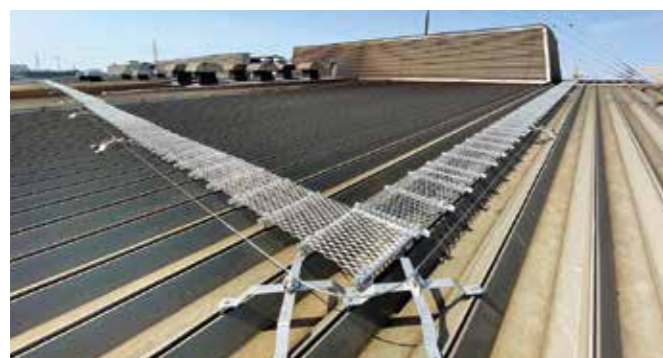
某工場 様(栃木県)
