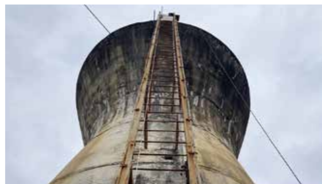
沼田市役所(沼田浄水場) 様 用途: 高架水槽へのアクセス
