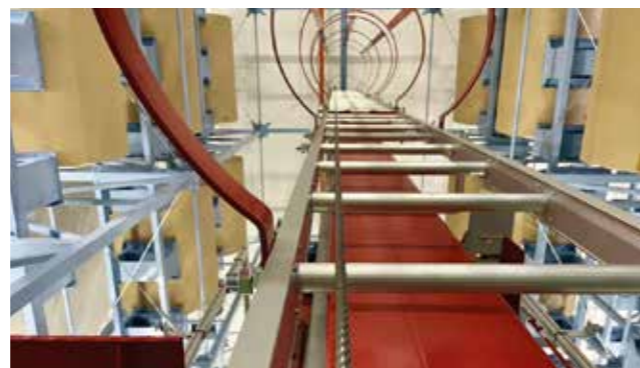
住化加工紙株式会社 いわき工場 様 用途: 設備点検用の昇降
