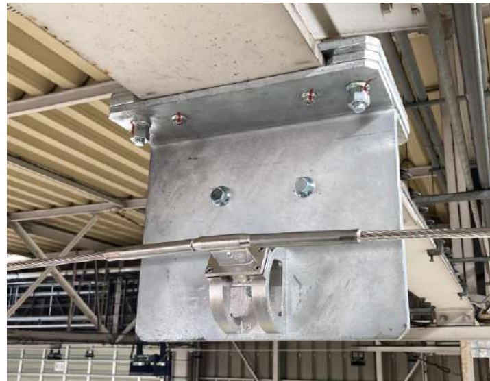
H型鋼への設置例
